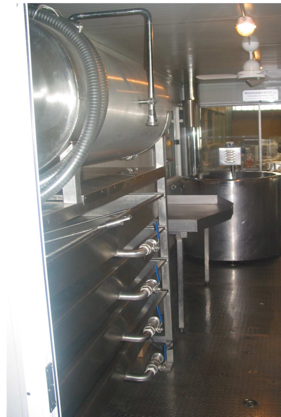
Serbatoio vasche rassodamento e scalfatura
